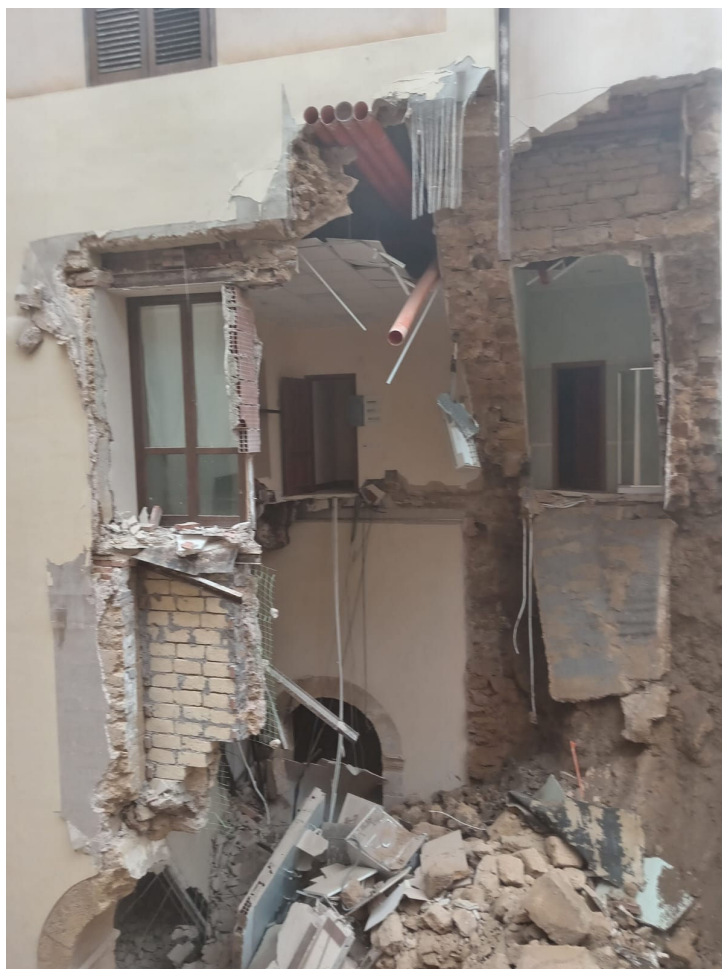
Figura 4.7: Parte crollata priva di sostegno
