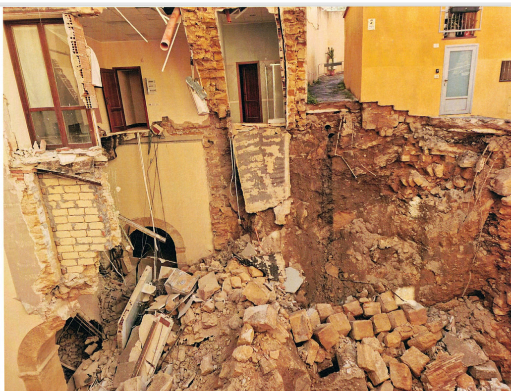
Figura 4.3: Crollo del muro e primi due piani studentato
