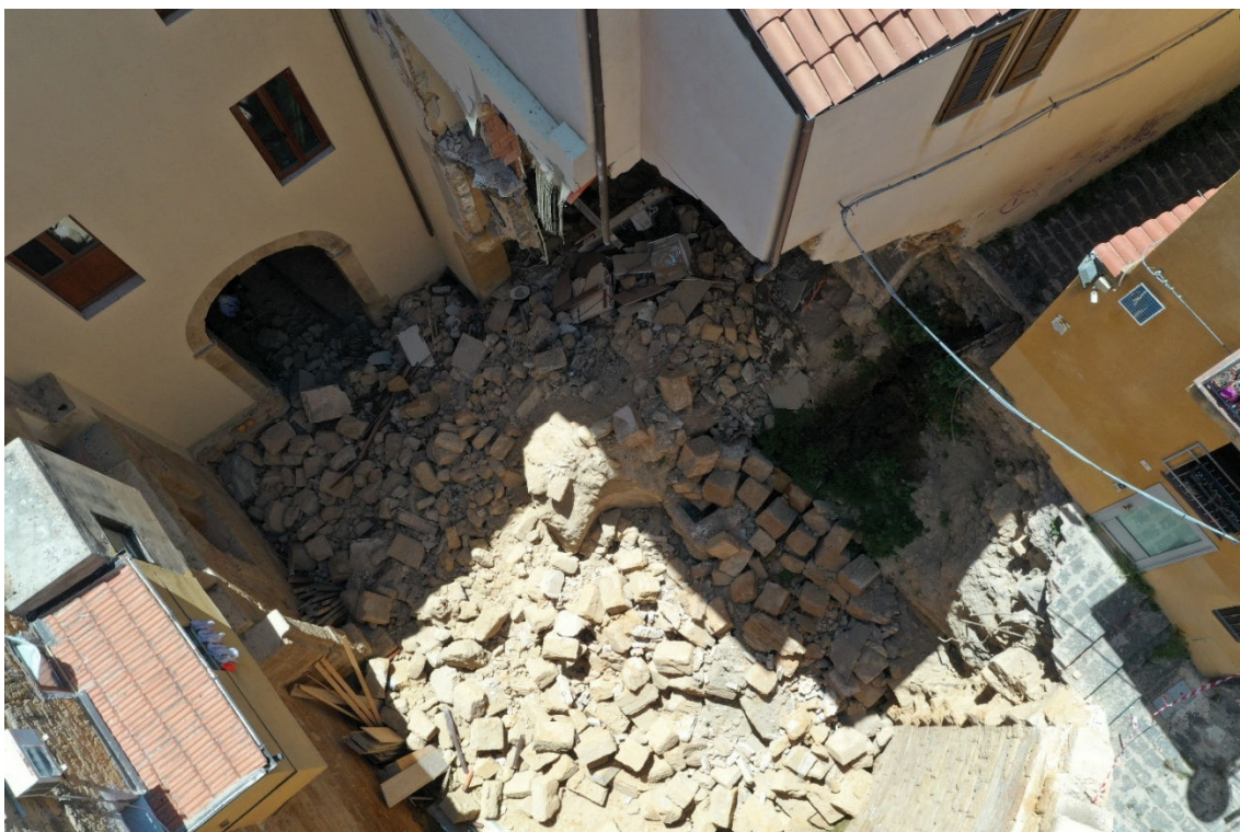
Figura 4.2: Vista aerea relativa al crollo del muro e primi due piani studentato
